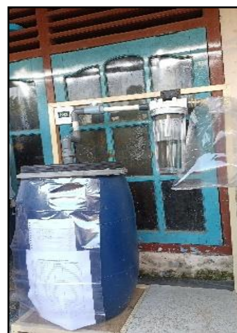
Gambar 5. Penampung biogas pada digester pertama
